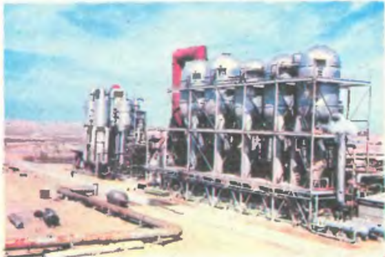
Атомная опреснительная установка в Шевченко
